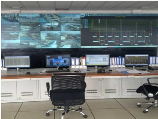
■ 石化生产控制中心
